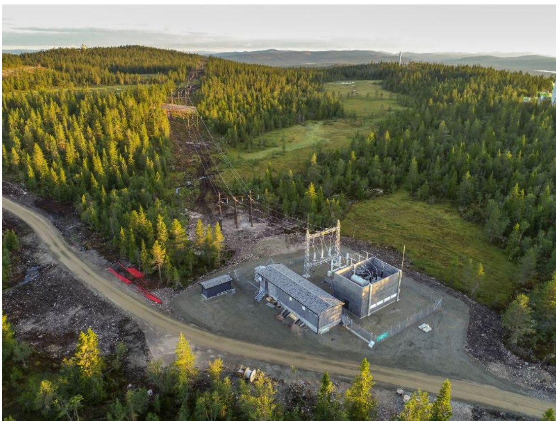
Transformatorstation vid OX2:s vindpark Raskiftet i Norge.
